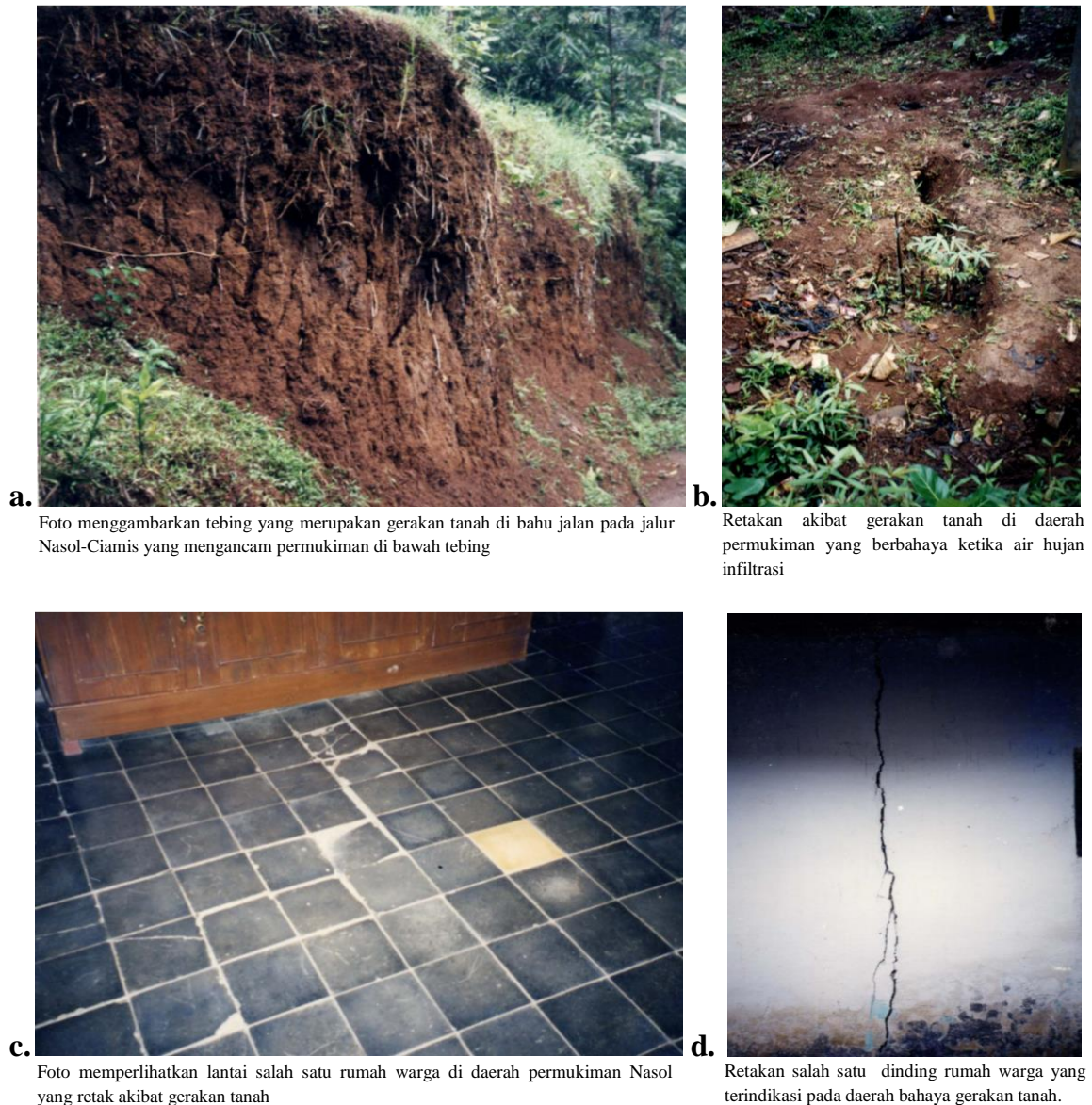
Gambar 1. Dampak Kerusakan dari Gerakan Tanah dan Longsor di Nasol
