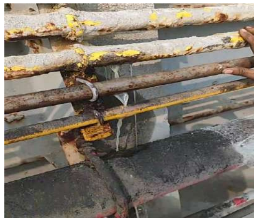
Gambar 1 Kebocoran Pipa Hidrolik Pada Tutup Palka
