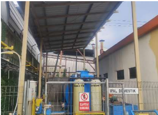
Gambar 5 Fasilitas IPAL domestik
