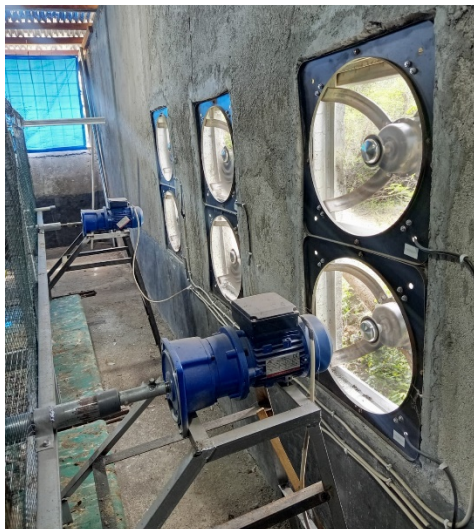
(A). Exhaust Fan,
