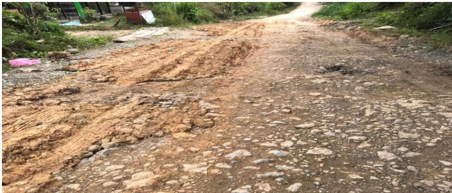
Gambar 1. Kondisi Jalan Utama Semoi II
